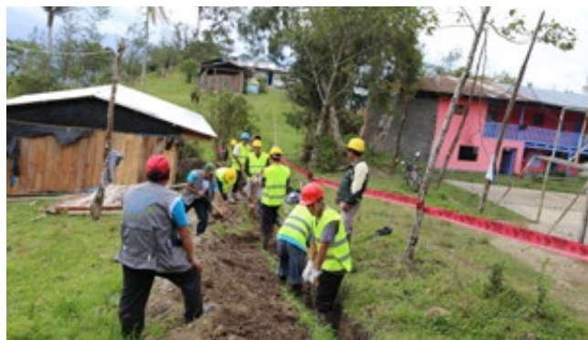
Se apoya a la gestión del saneamiento, la depuración de aguas residuales y el reúso.
