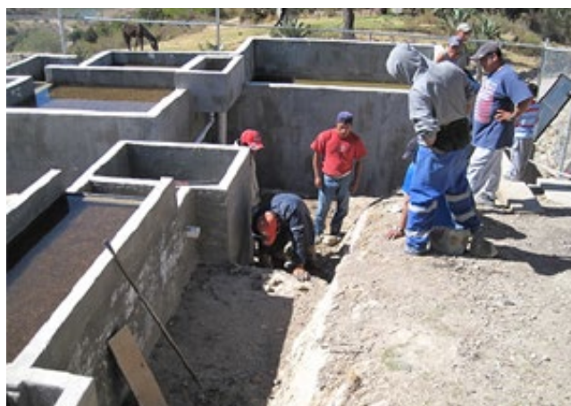
Figura 2. Planta potabilizadora La Peregrina.
