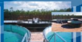
PLANTA DE TRATAMIENTO (México)
