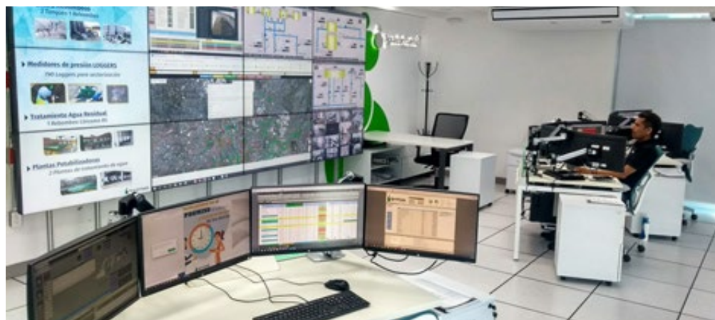
Por medio de este centro es posible medir en tiempo real el flujo y la presión con que se recibe y abastece el agua potable.
