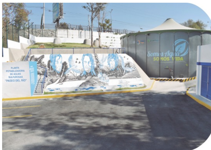
Planta potabilizadora de agua sulfurosa.
