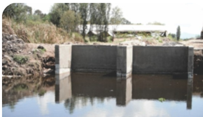
Cárcamo de bombeo.
