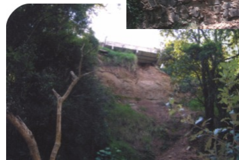
Talud Erosionado por las lluvias.
