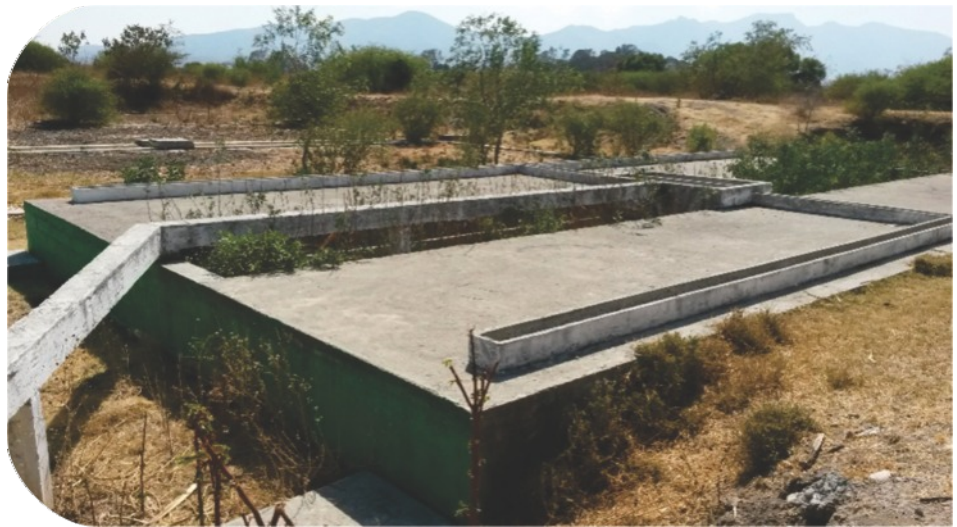
Figura 1. Planta de tratamiento de aguas residuales municipales.
