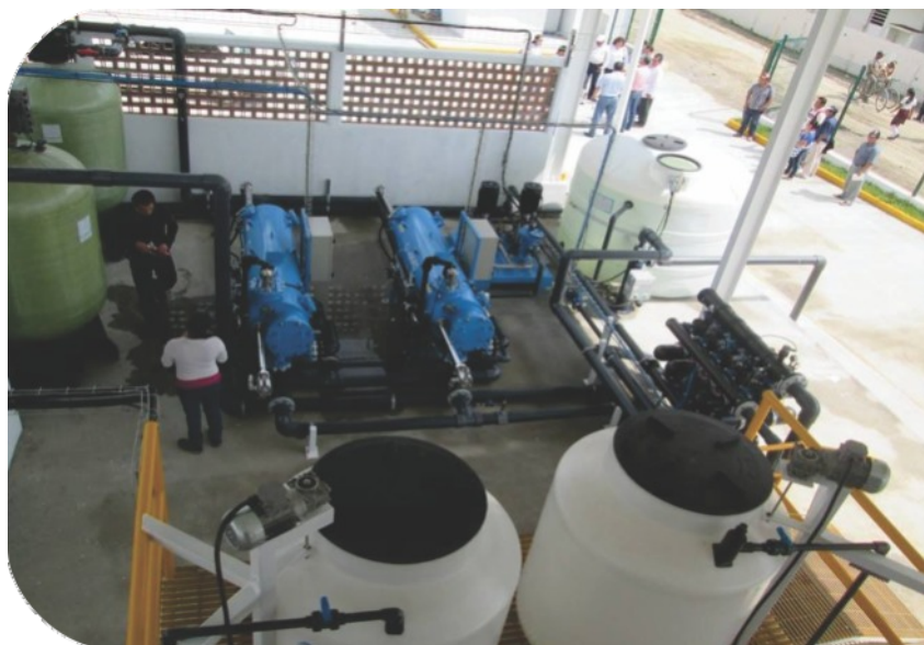
Planta de tratamiento en el poblado Quintín Arauz, municipio de Centla.
