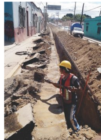
Obras de sustitución de aproximadamente mil 200 metros lineales de tubería (PVC) de alcantarillado sanitario hermético.
