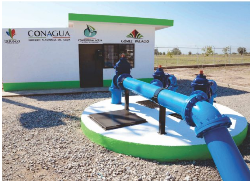
Cárcamo del sistema de agua.
