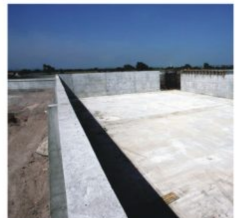
Digestores de Lodos
