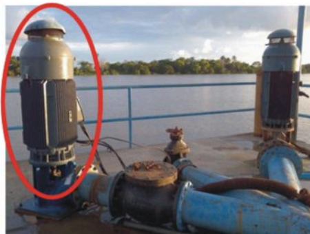
Ilustración 1. Obra de captación. Equipo en operación nuevo.
