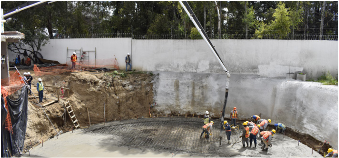
El macrotanque Stanley se concluyó y comenzó a operar en febrero de 2020.
