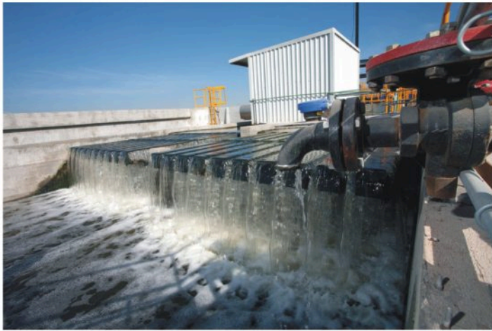
La planta de tratamiento de aguas residuales tiene la capacidad de producción de biogás.
