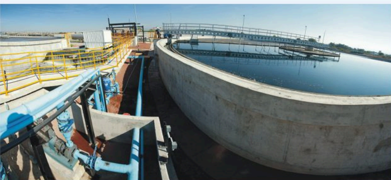
Planta de tratamiento de aguas residuales de San Pedro Mártir.
