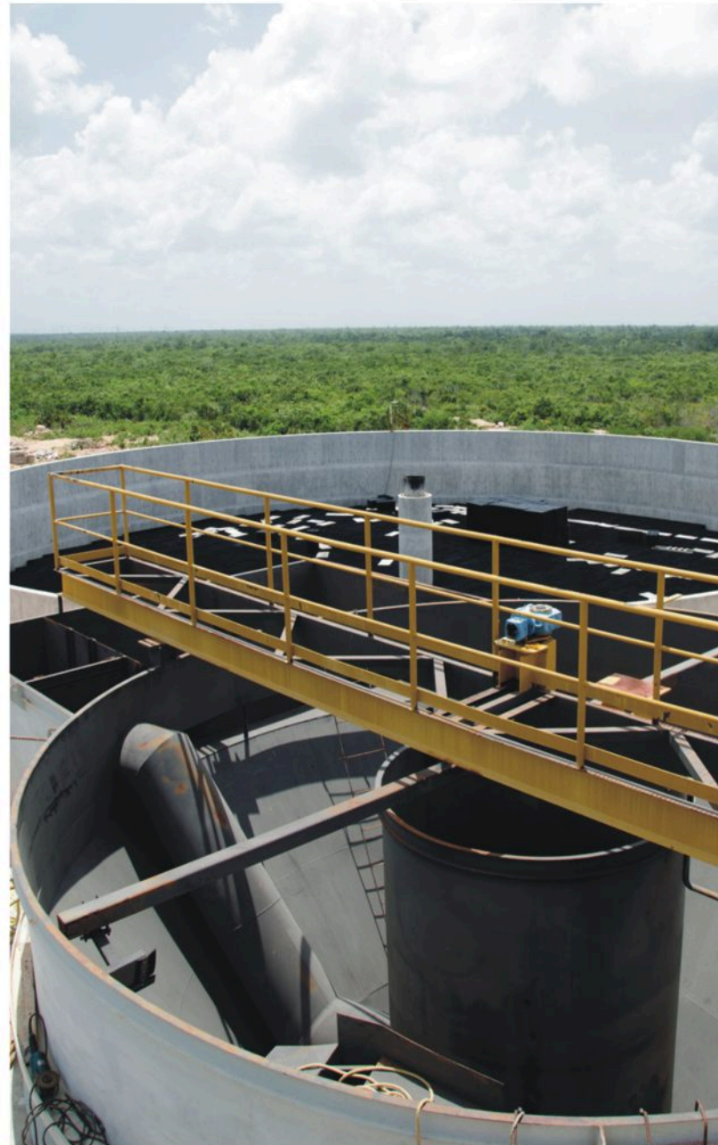
Planta de tratamiento de aguas residuales Polígono Sur, en Cancún.
