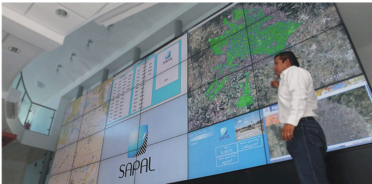
Centro de Monitoreo y Control SAPAL .
