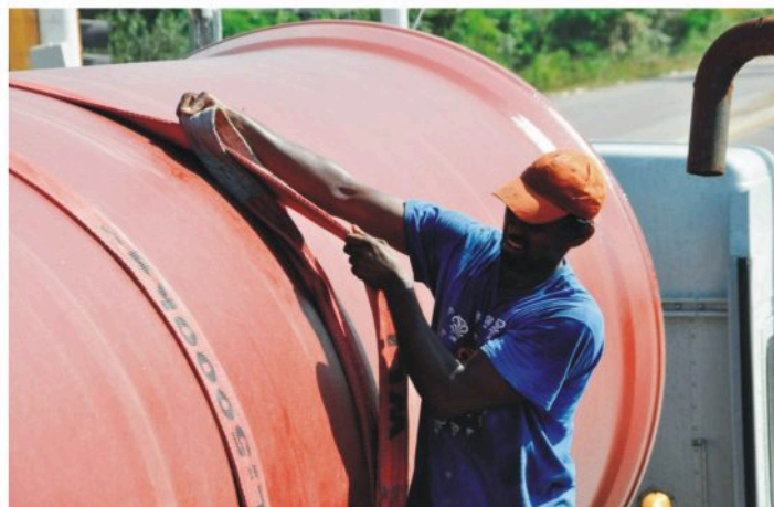
Tubería de hierro dúctil para el colector.
