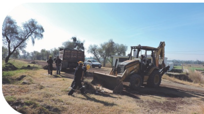
PTAR produce agua de reúso para riego agrícola, lo que brinda la posibilidad del rescate de tierras de cultivo aledañas.
