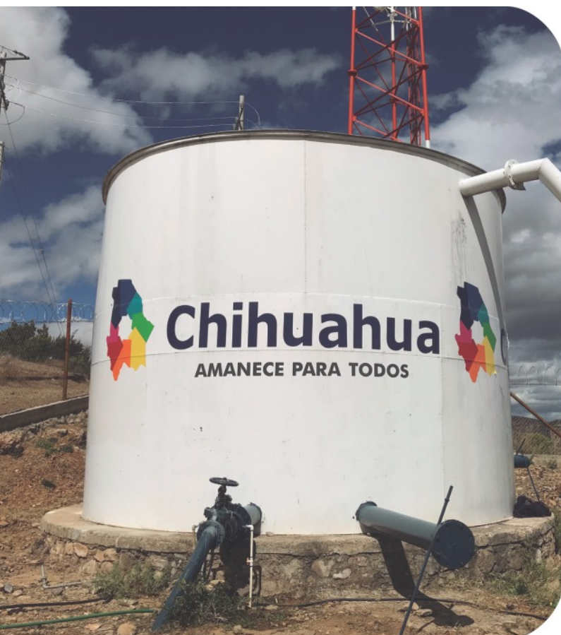
Tanque de almacenamiento en Santa Bárbara.
