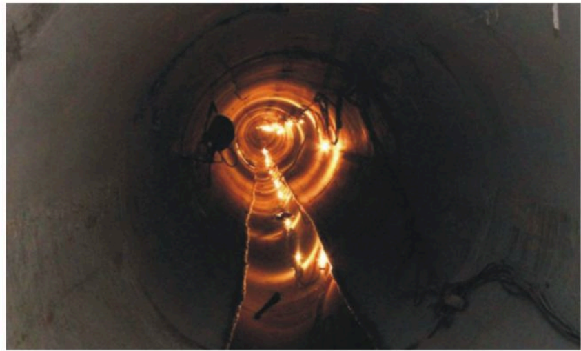
Esta obra capta y conduce las aguas residuales de la red de colectores que vienen desde la presa Las Rusias y hasta San Martín de las Flores.
