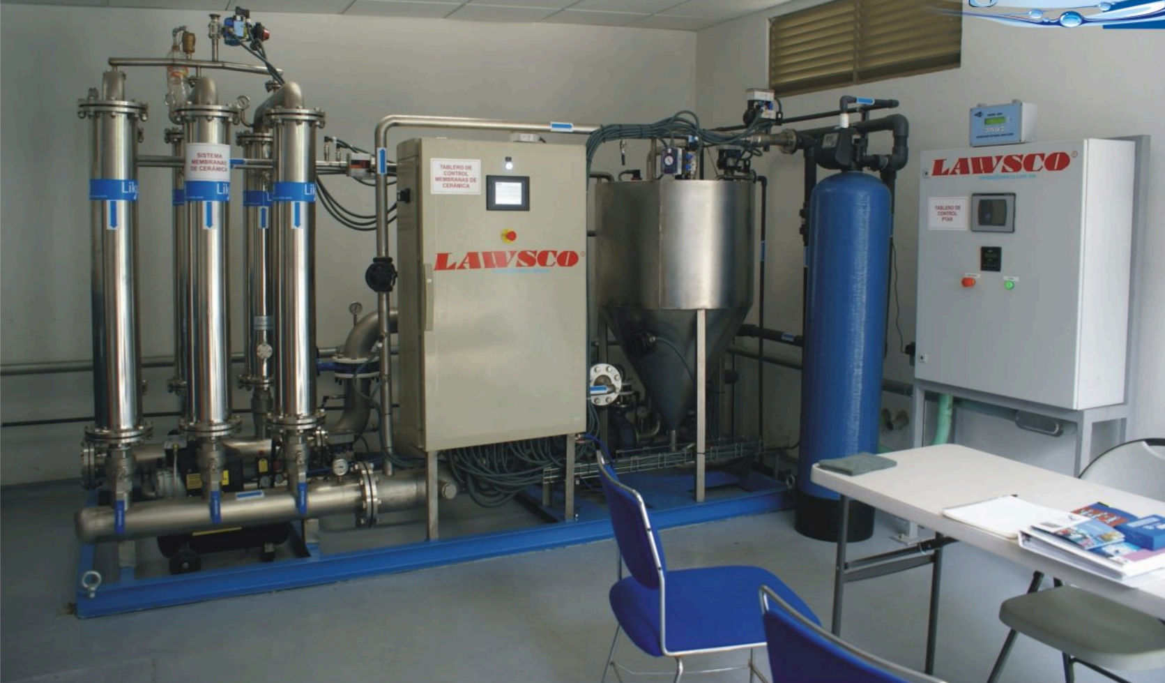
Sistema receptor de aguas negras.
