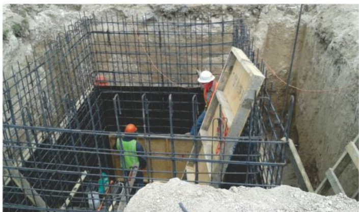
Construcción de la laguna de lodos en la planta potabilizadora Rancho Grande.
