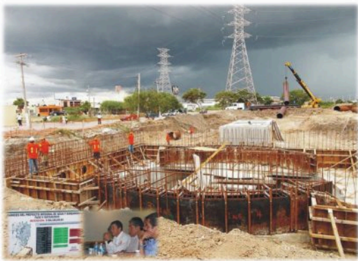
Segunda fase de Proyecto Integral de Agua y Saneamiento de Matamoros, Tamps.
