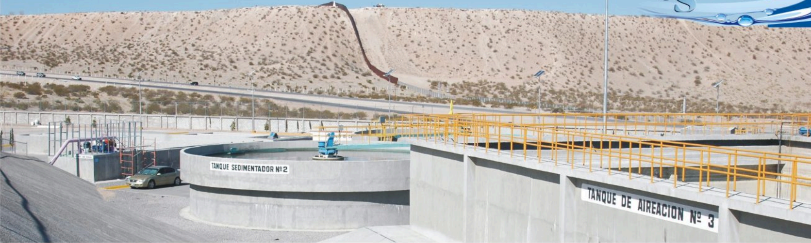
Planta de tratamiento de aguas residuales de Anapra.
