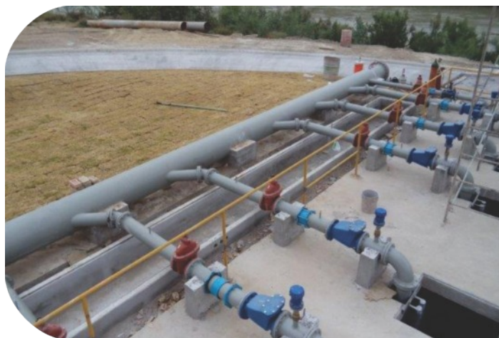
Planta potabilizadora Norponiente.
