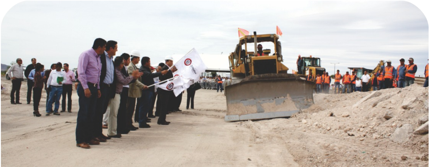
Banderazo para la construcción de las plantas de tratamiento en Delicias, Chihuahua.
