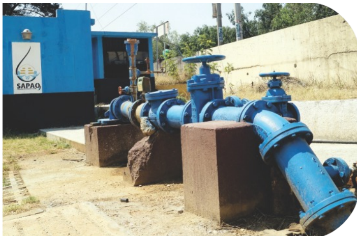
Instalaciones de SAPAO en Oaxaca.
