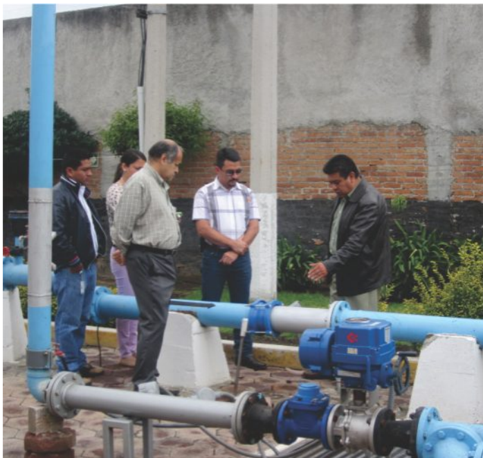
Delegación hondureña en planta de tratamiento del Organismo de Agua Potable OPDM , Tlalnepantla de Baz.
