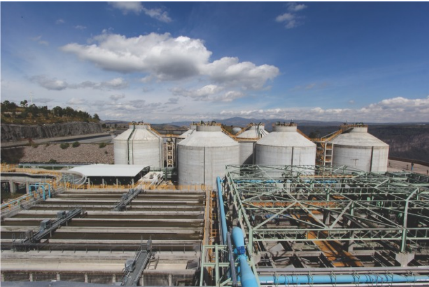
Planta de tratamiento de Agua Prieta.
