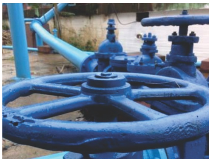
Válvulas de plantas potabilizadoras.
