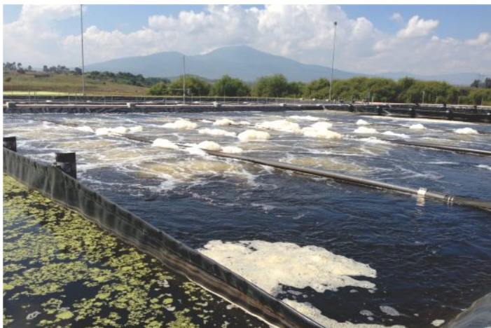
La planta tratadora de aguas residuales Los Itzícuaros.
