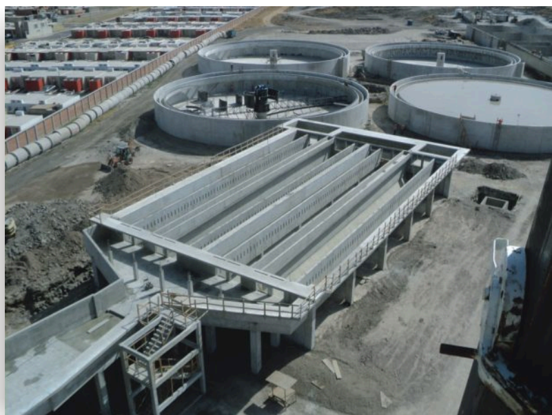
Unidad de Tratamiento de Desarenado y Desengrasado, al fondo se muestran los Clarificadores Primarios.
