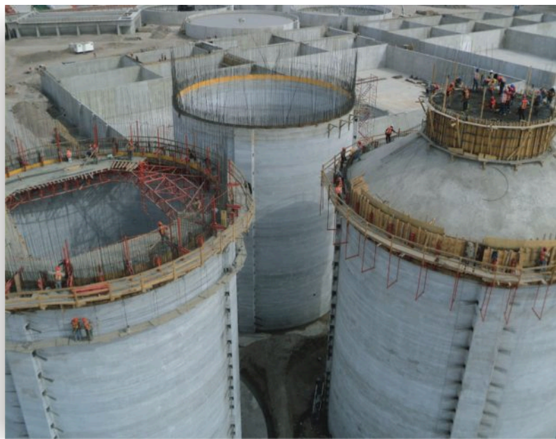
Vista aérea de Digestores Anaeróbicos de Lodos.
