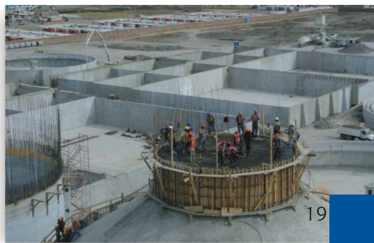
Vista de la Planta, parte alta del Digestor de Lodos y Reactores Biológicos.
