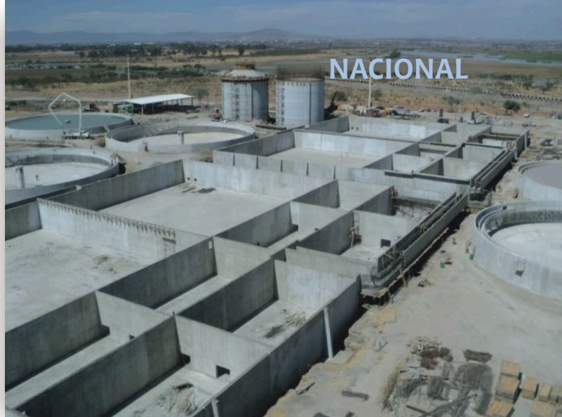
Vista de los Reactores Biológicos, al fondo Clarificadores Secundarios y Digestores de Lodos.
