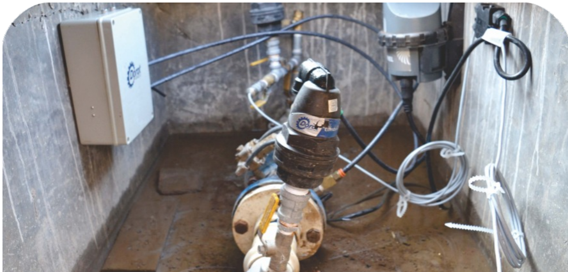
Sistema de monitoreo de las redes de distribución que transmitirá información vía remota de la cantidad de agua y presiones en las redes.
