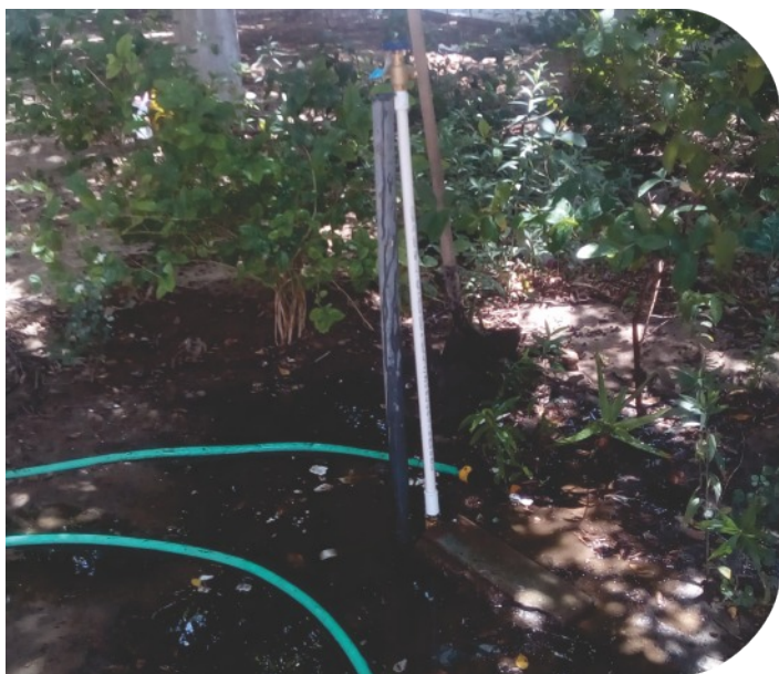
Escuela Foránea No. 2, fuga de agua en llave de riego.
