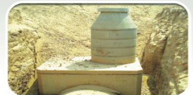
POZO DE VISITA
