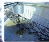
Espesadores de Lodos
