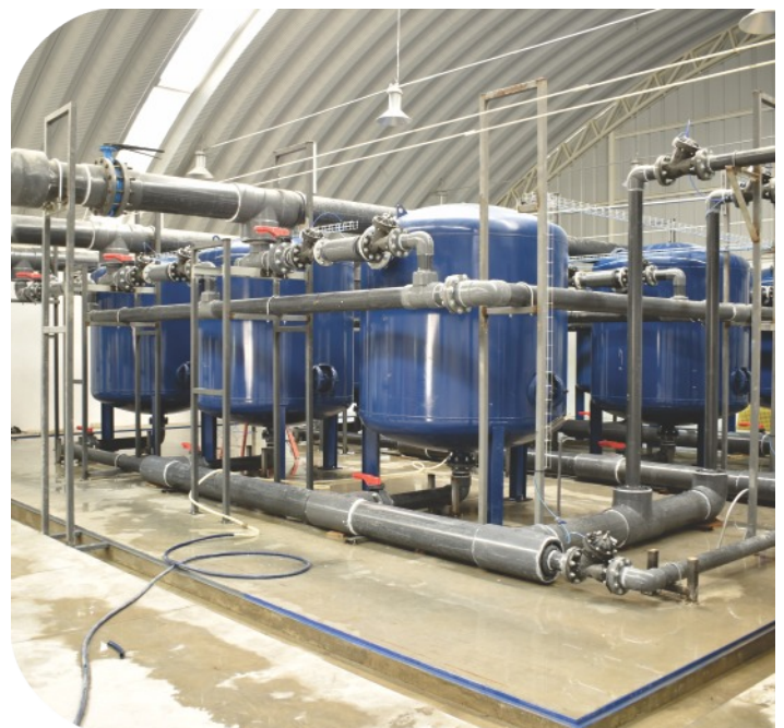
La potabilizadora cuenta con tecnología de Osmosis inversa.
