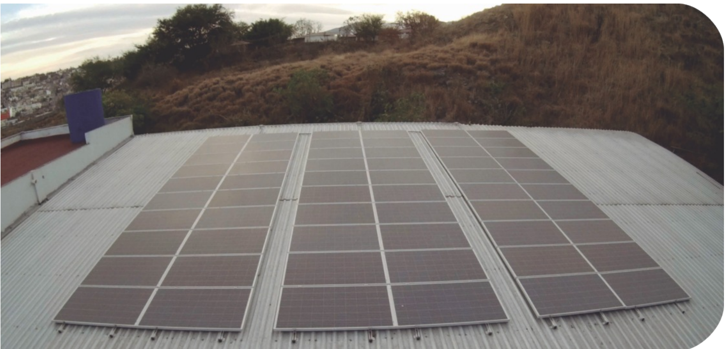
El equipo fotovoltaico tiene capacidad de generación de energía de hasta 14 kilowatt/hora para cubrir el 100% del consumo del edificio principal del Organismo.
