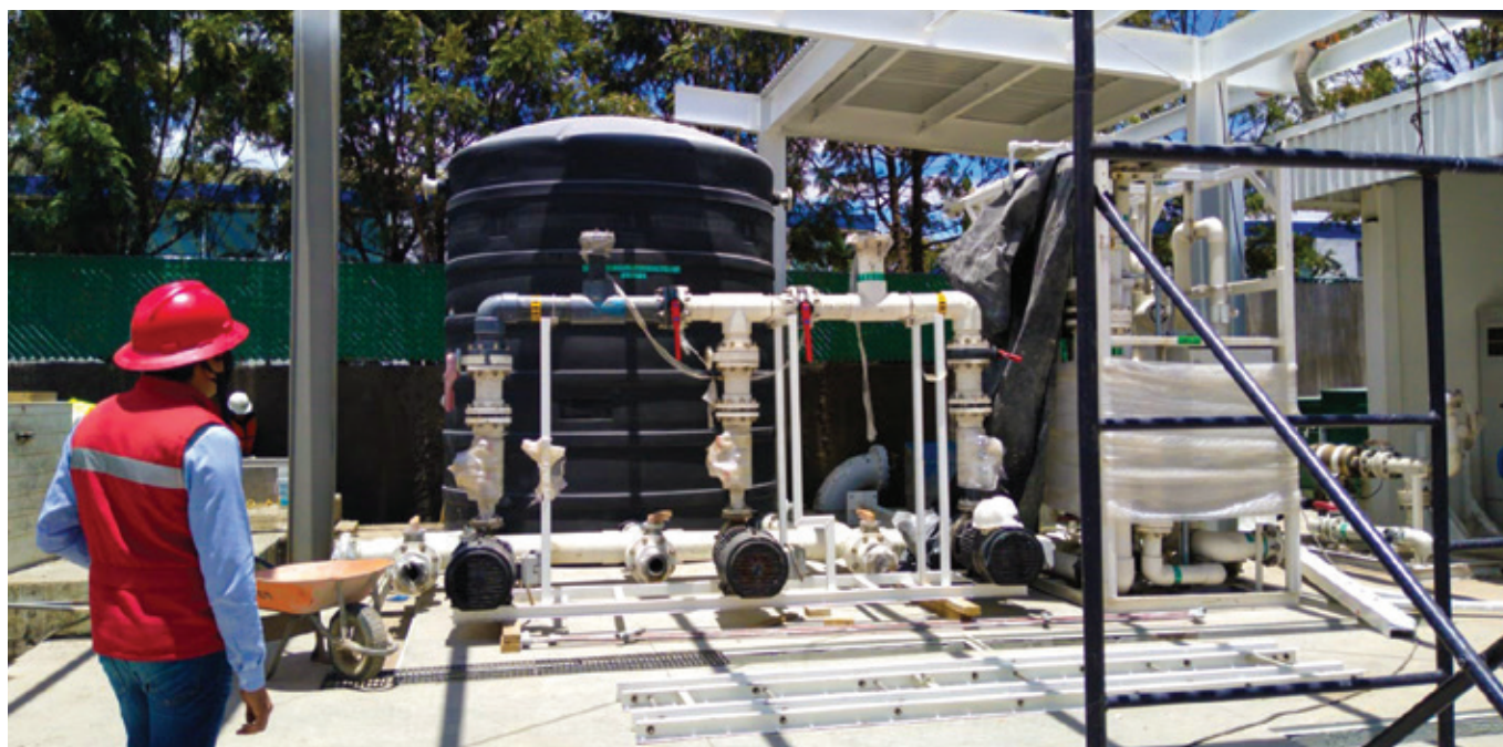
Se tienen en operación cuatro plantas potabilizadoras y ablandadoras de agua.
