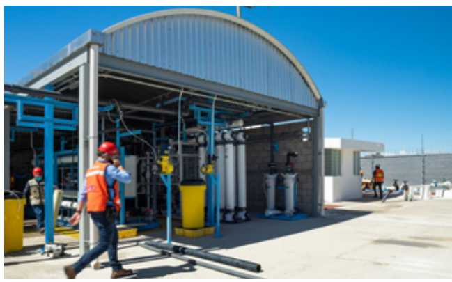
La planta ablandadora Zapata fue construida para eliminar la dureza y potabilizar el agua proveniente del pozo Zapata 3, mediante procesos de ultrafiltración y ósmosis inversa.
