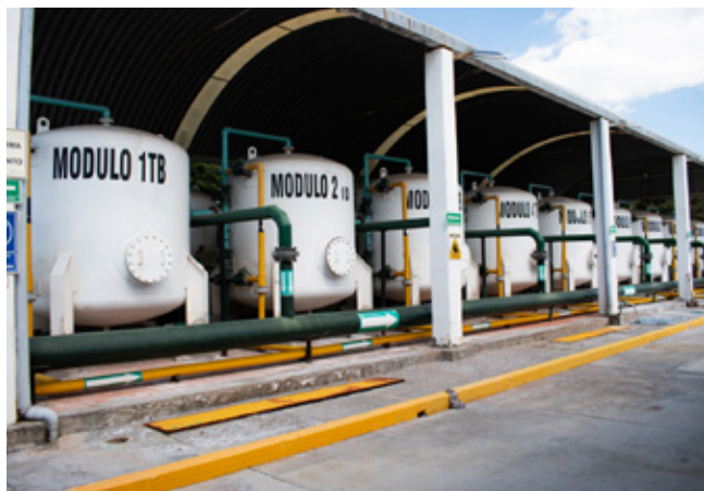
La planta Quetzalcóatl incrementó su producción de 90 a 150 L/s; con ello se benefician 108,620 habitantes de 138 colonias en la ciudad de Puebla.
