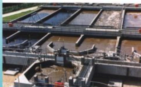
Tratamiento de aguas residuales
