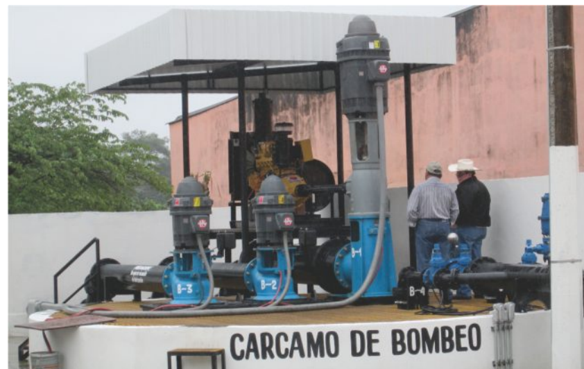
Cárcamo de bombeo en Jalpa, Tabasco.
