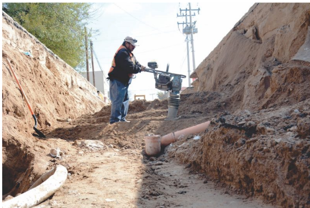
La COMAPA tendrá un proceso de tratamiento del 98% de sus aguas residuales, gracias a la separación de aguas pluviales así como residuales.
