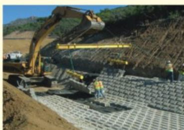
AarmorFlex es fácil de instalar y tiene un bajo coste de ciclode vida.
