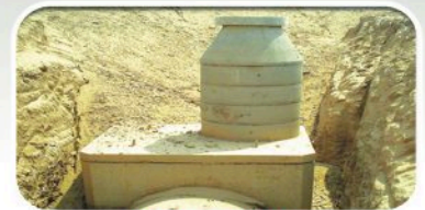
POZO DE VISITA
