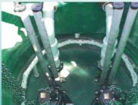
Instalación típica de bombas Tsurumi en cárcamo de bombeo
