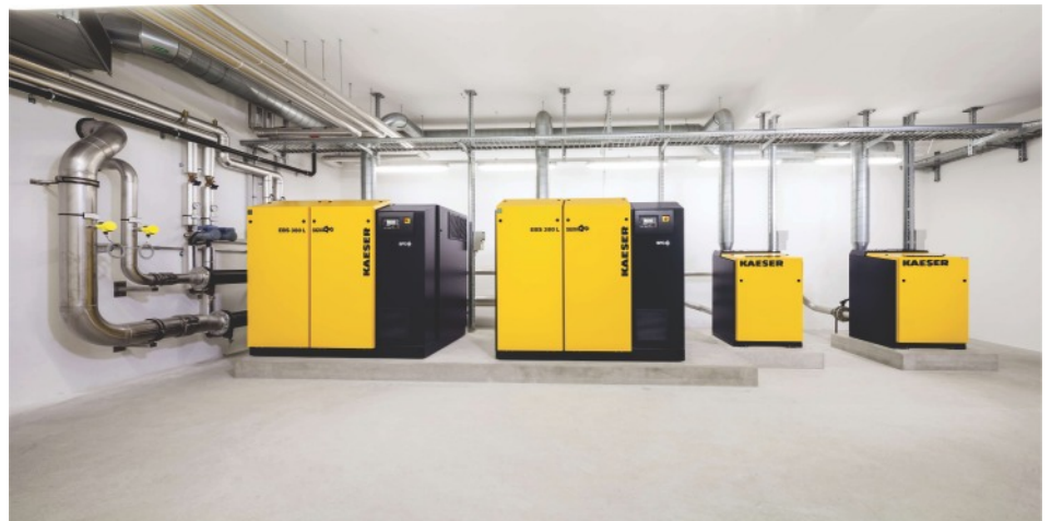
Estación de sopladores serie EBS KAESER, soluciones de eficiencia energética para sistemas de tratamiento de aguas residuales.
