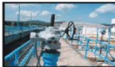
Cutzamala Area de Filtración
