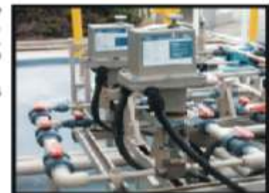
Control de Inyección de Químicos (dosificador)
