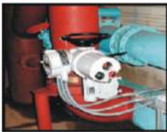
Actuador IQ en Sistema de Aeración
