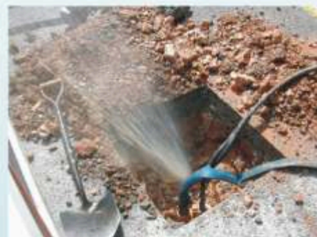
Fuga detectada (0.86 l/s) y priorizada con Leak Sizer.
